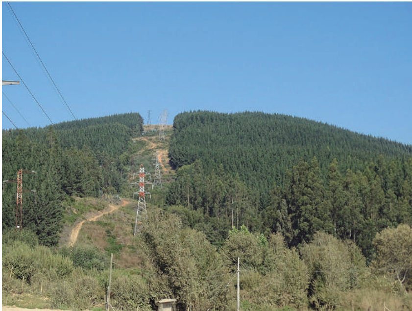
Figura 31: Líneas eléctricas con fajas libres de vegetación.
